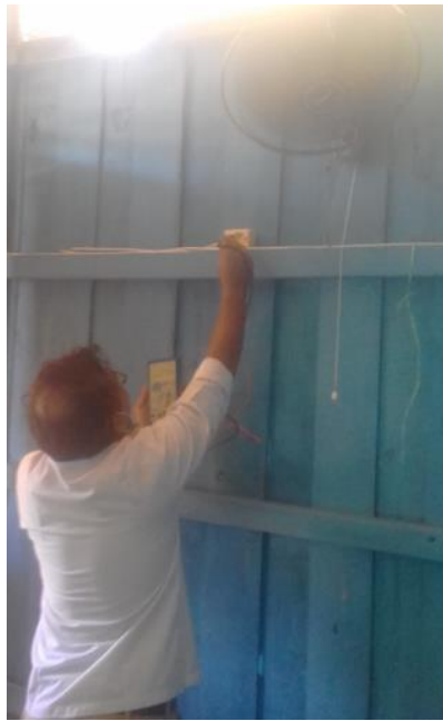
Gambar 7. Pengujian Instalasi beban
